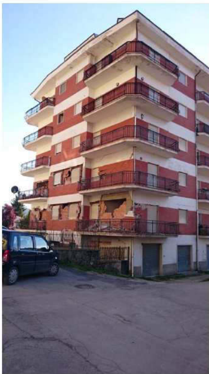
Amatrice: Edificio in c.a.: danni alle tamponature esterne che hanno collaborato con la struttura in c.a. ad assorbire l'energia del terremoto.
