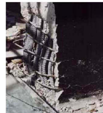
Esempio rottura al piede di un pilastro con espulsione cls e piegatura dei ferri
