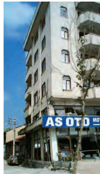
Edificio irregolare in altezza: "piano debole": la parte in elevazione "trasla" e spacca i nodi al primo piano.
