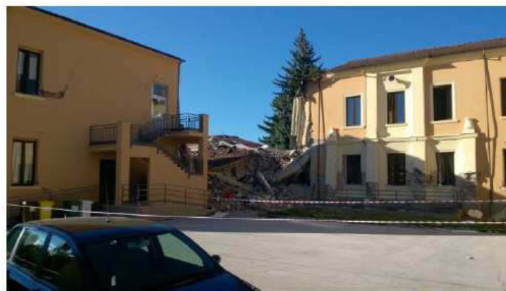
Scuola Amatrice: edificio al "L" Crollo dell'angolo per concentrazione sollecitazione
