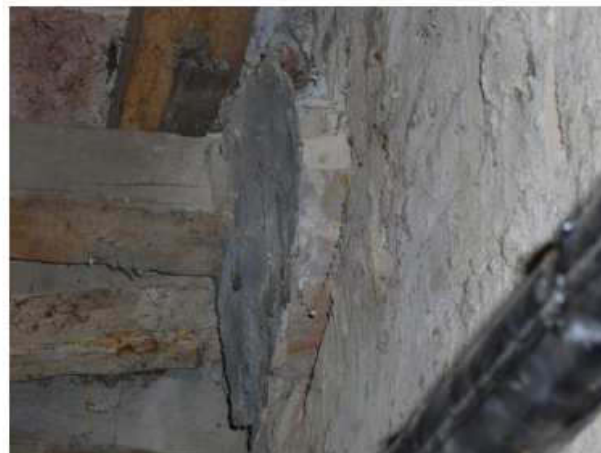
Villa Alessandrini – La trave in legno spinge in fuori il muro che non rientra più.
