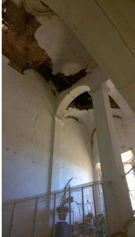
Crolli locali di elementi non strutturali (S. Angelo in Pontano)
