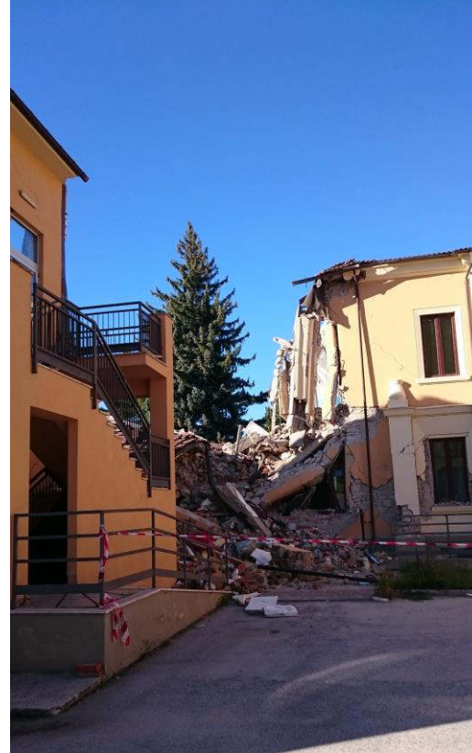
Crolli locali all'incrocio delle ali di un edificio a C (Scuola ad Amatrice)
