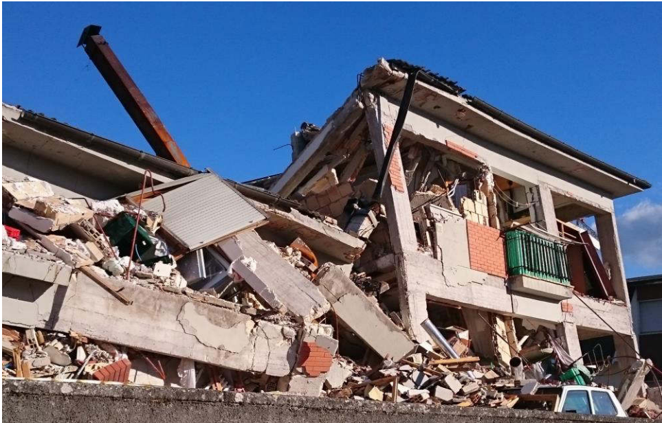
Crolli in edifici in C.A. con travi molto rigide e pilastri esili (Amatrice)
